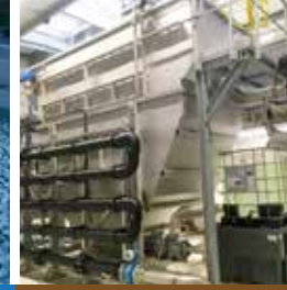
مياه الصرف الصناعية
