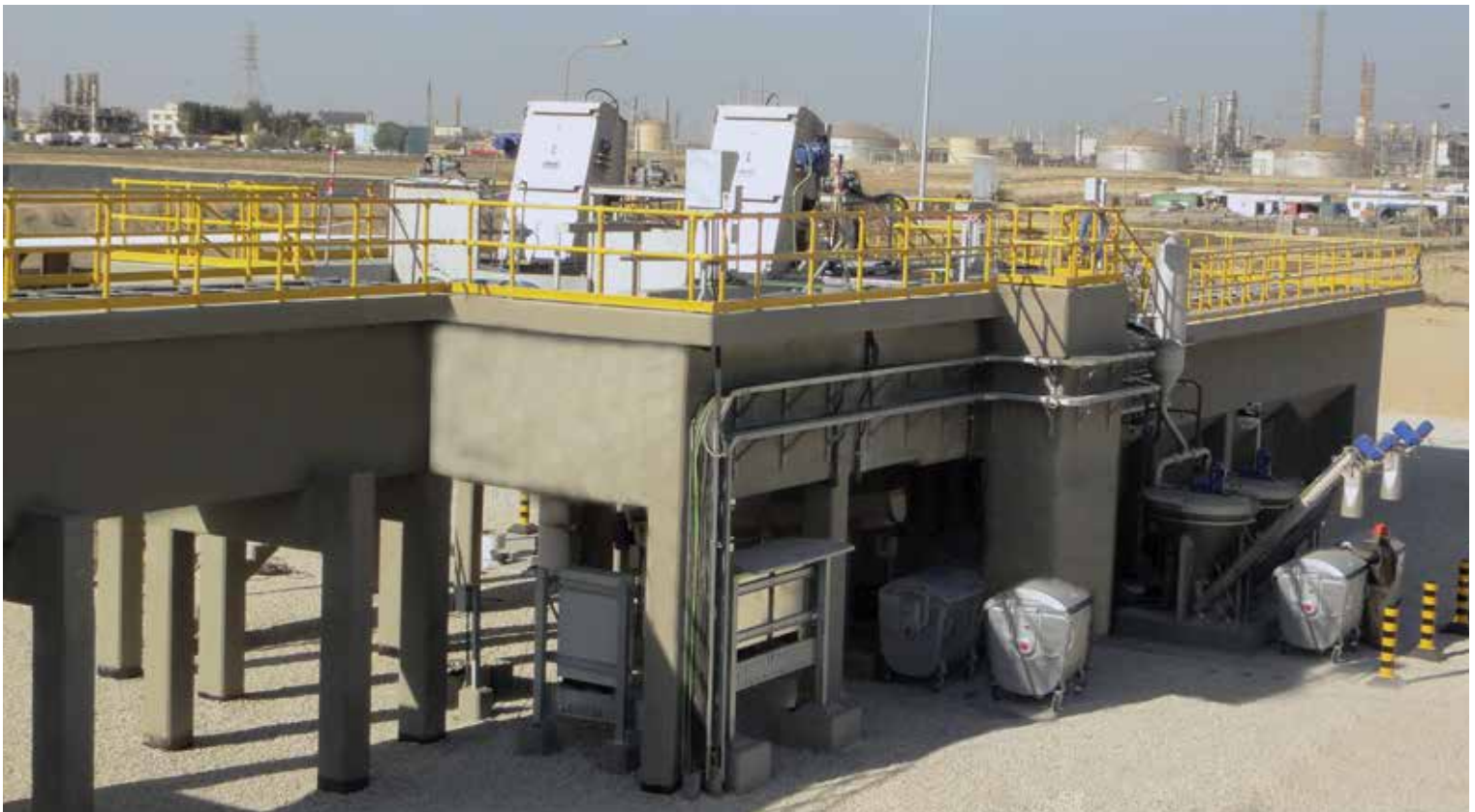
محطة للمعالجة الأولية لمياه الصرف الصحي بطاقة 4000 م 3 /يوم، لشركة مرافق، الجبيل المملكة العربية السعودية
