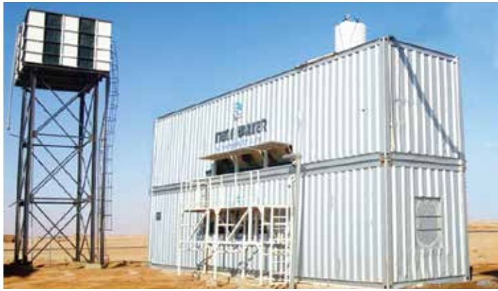
Umkatti - traitement d'eau potable - Khartoum, Soudan
