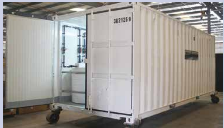
Sustav za obrnutu osmozu slane vode 300 m 3 /d, Moskva, Rusija
