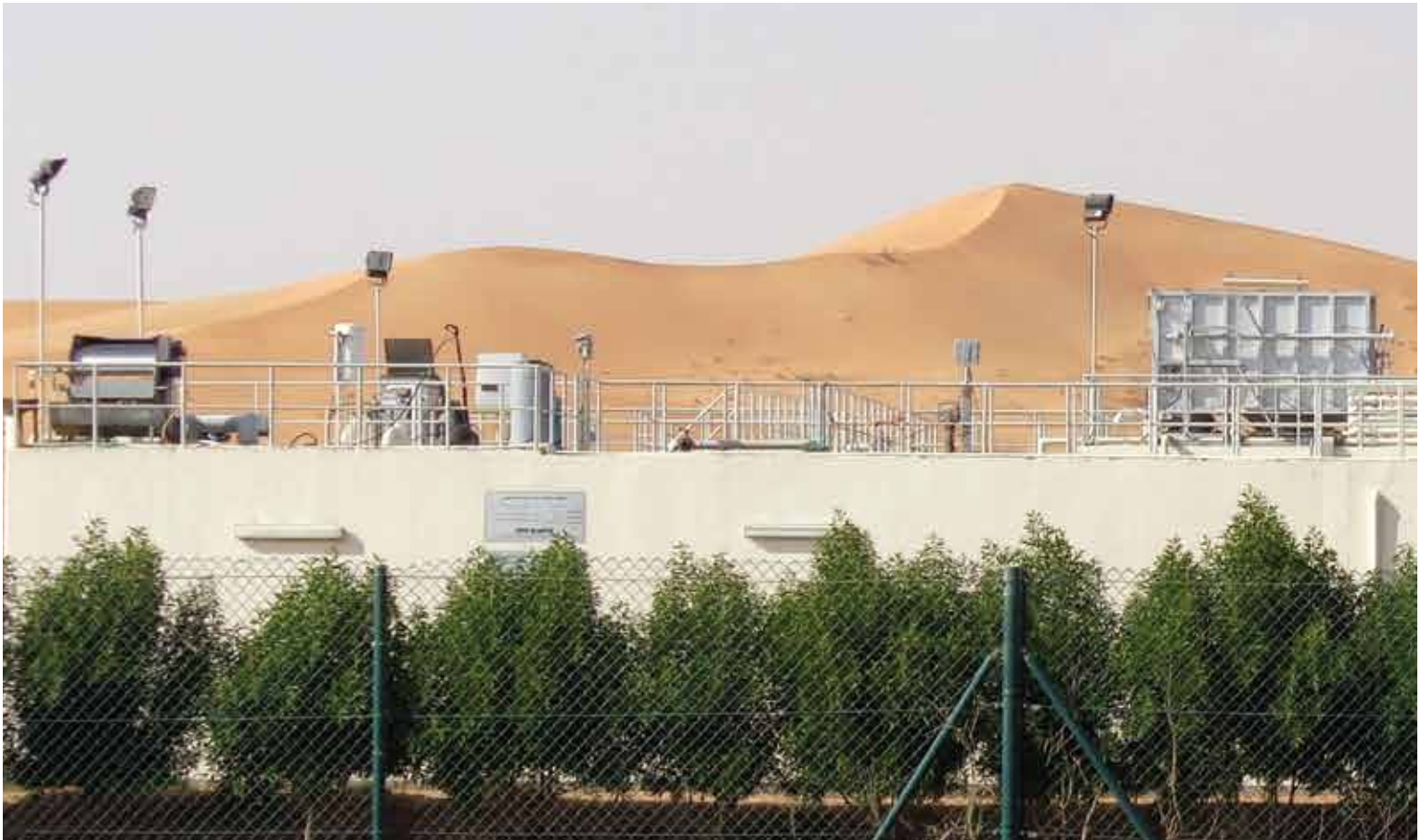
Al Ain - Птицеферма & Переработка , Станция очистки сточных вод, 400 m 3 /day
