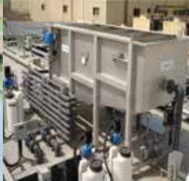
Industrijska odpadna voda
